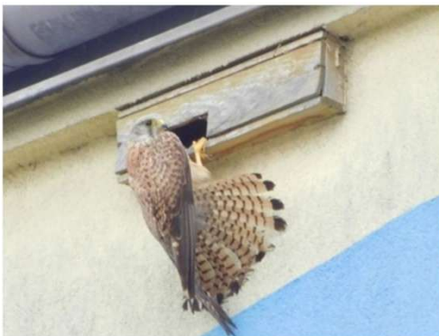
Drewniana budka dla jeryka, prawidłowo zamontowana, wpuszczona w ocieplenie i schowana pod gzymssem, ale z wypaczoną przednią ścianką; pustulka przeszukująca budki
