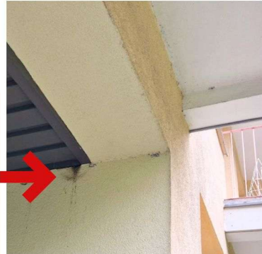
Ślady piór na elewacji
