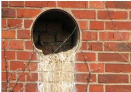
Zabrudzenie elewacji odchodami
